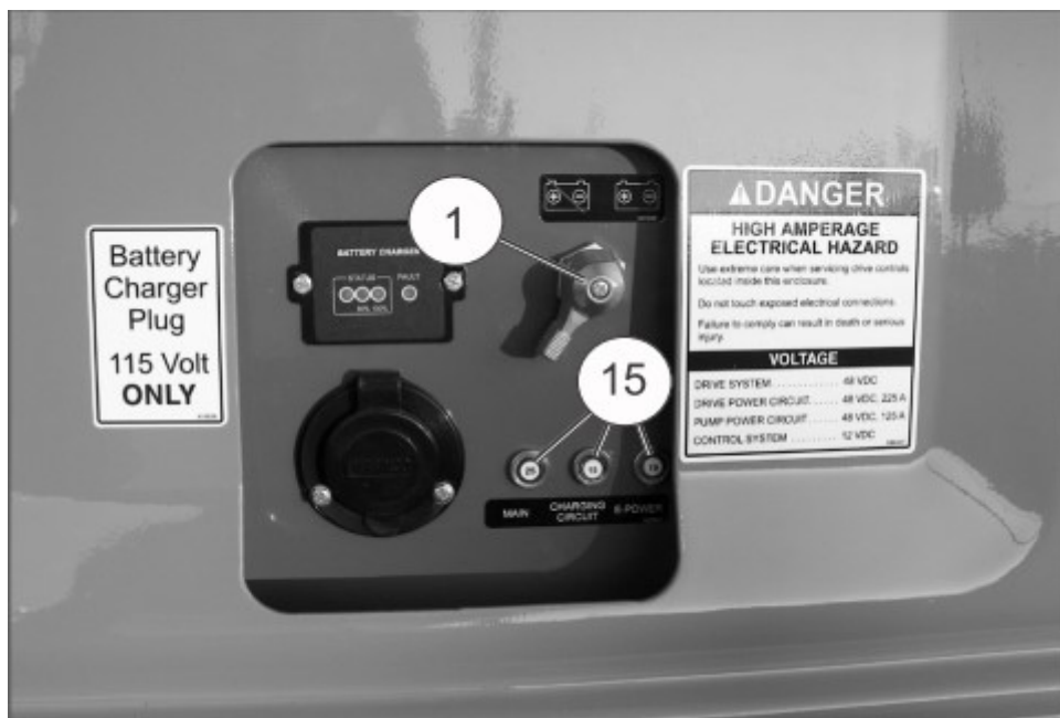
1. バッテリー電源切断スイッチ
