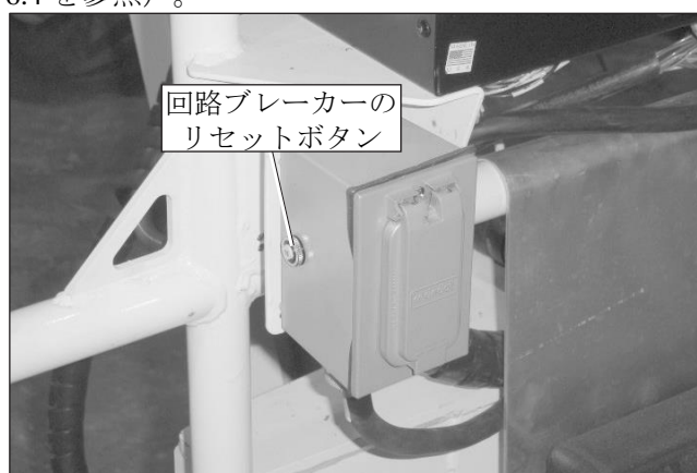
図 6.4 - 電源コンセント
