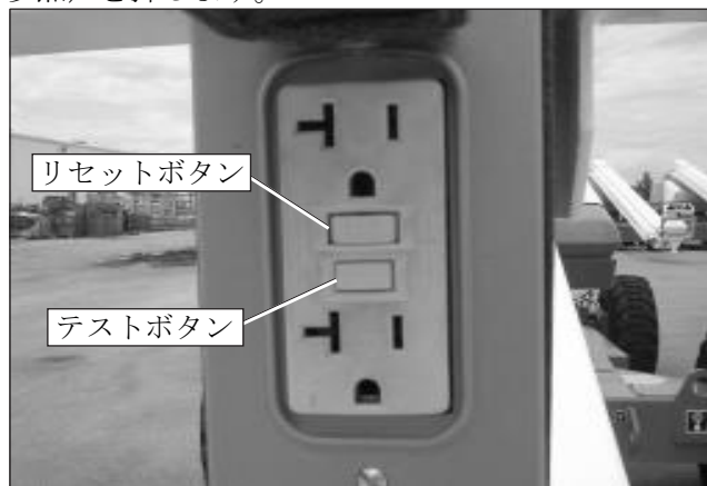
図 7.16 - 電源コンセント
