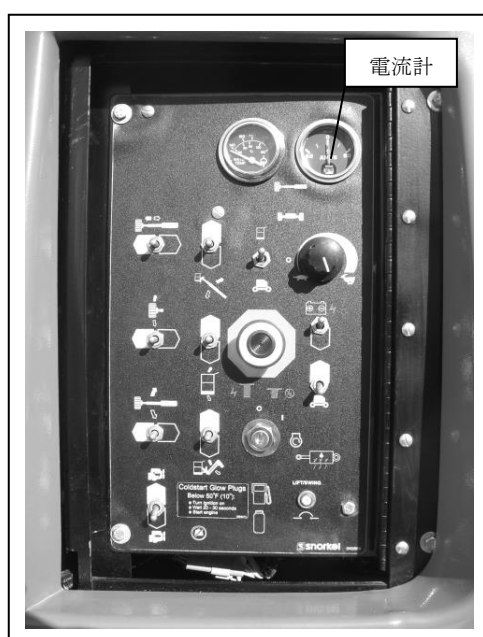
図 5.2-車体側操作盤
