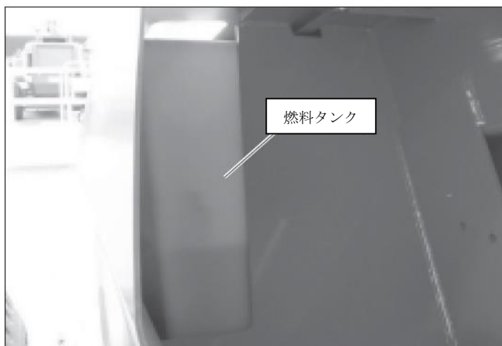
図 5.4ー燃料タンク
