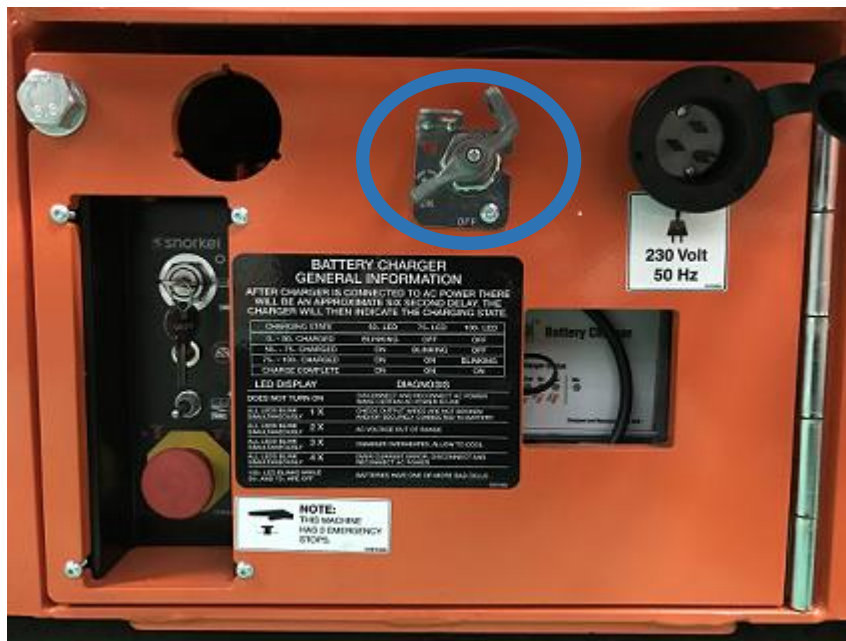
図 バッテリー切断スイッチ
