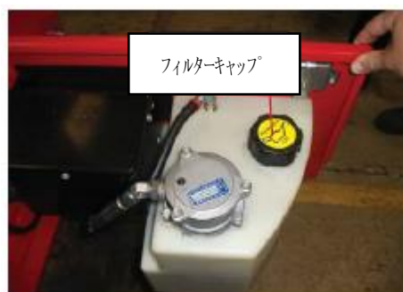
<作動油タンク>
