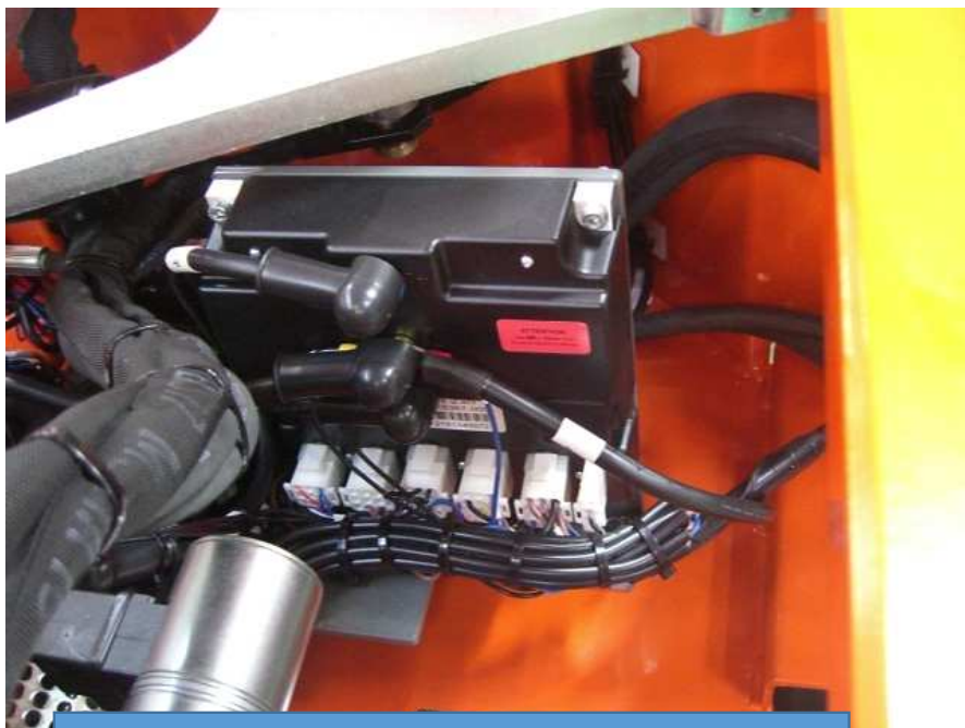
制御コンピュータ(EzCallシステム)
