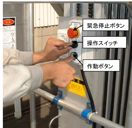
図4: 作業床内操作盤
